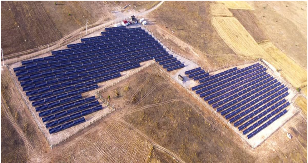
Şekil 2.6: Güneş enerji santrali
