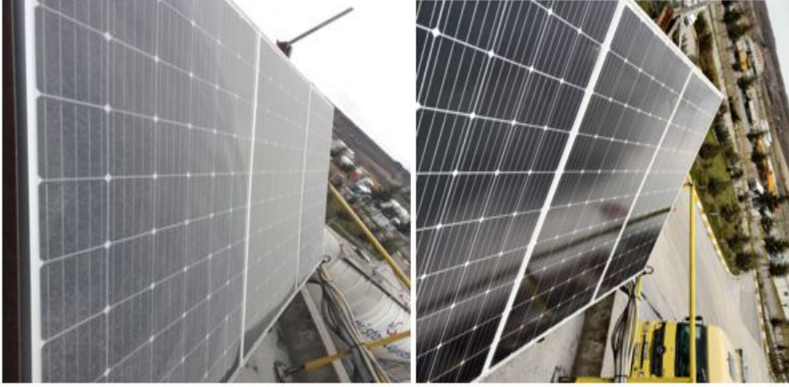
Şekil 7.31: MGES FV dizisinin yüzeyindeki toz kaynaklı kirlilik durumu
