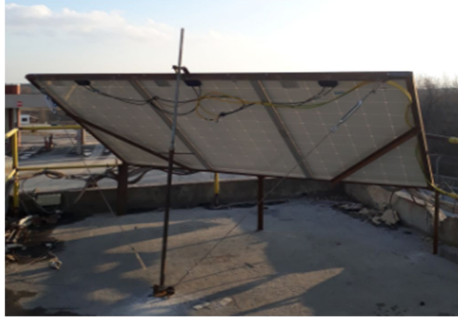
Şekil 7.29: MGES FV dizisinin sabit eksen güneş takip sistemi yapısının görünümü
