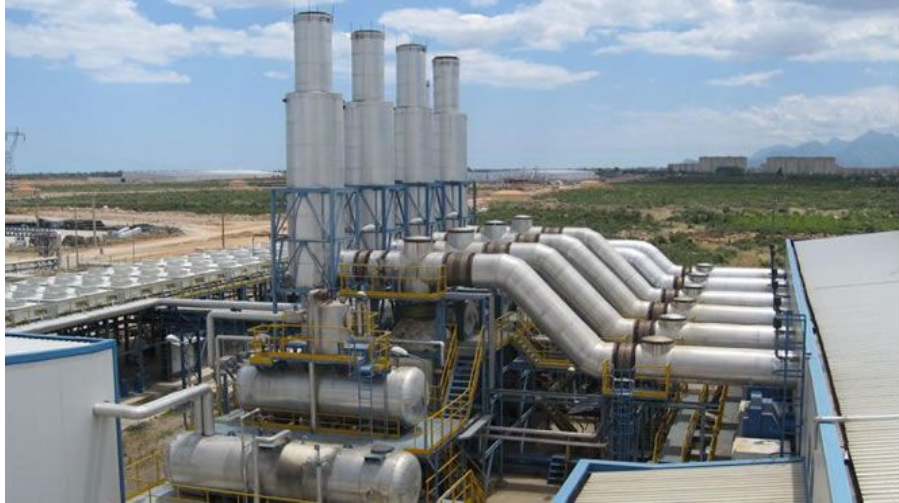
Şekil 2.4: Doğalgaz enerji santrali [44]
