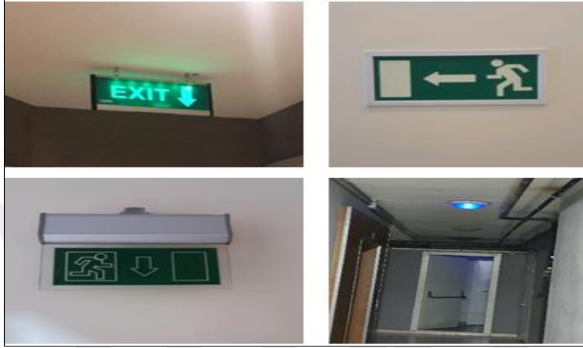
Resim 3.7. Acil durum aydınlatması ve yönlendirmesi
