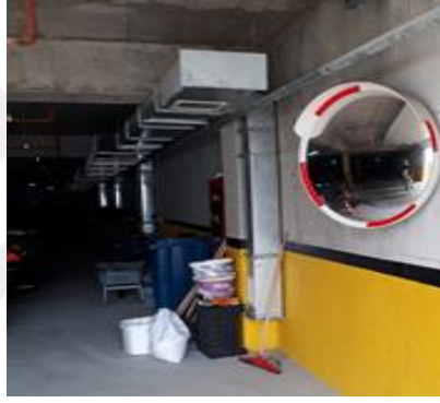
Resim 4.27. Önünde engelleyici malzeme bulunan yangın dolabı
