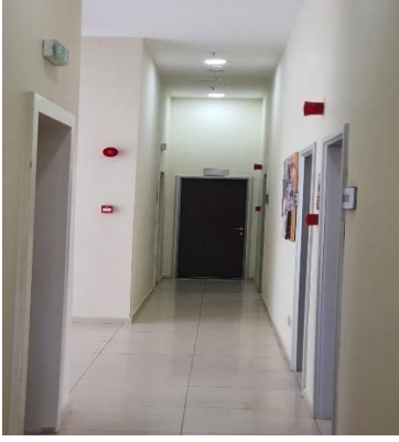
Resim 4.42. Yönetim binası alarm, dedektör, yangın söndürme butonu ve sprinkler
