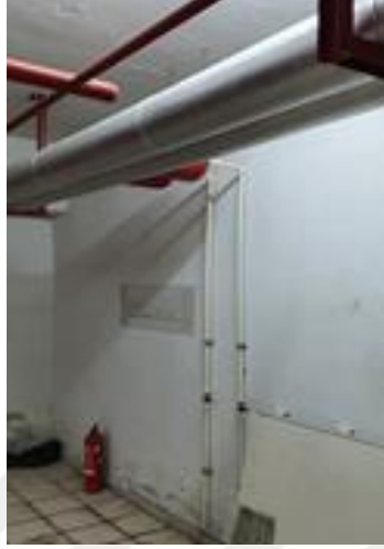
Resim 4.13. Kazan dairesinde yangın söndürme tüpü
