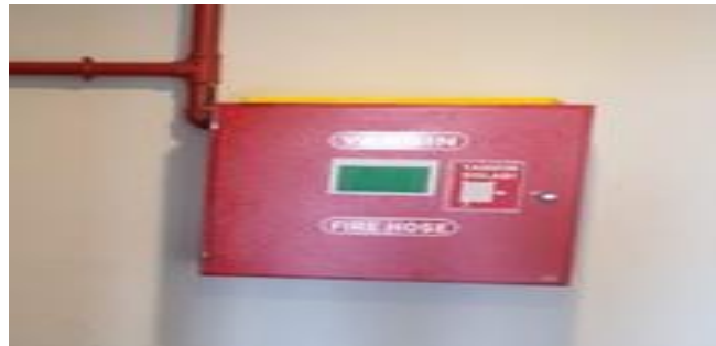
Resim 4.25. Söndürme ekip listesi iliştilmiş yangın dolabı
