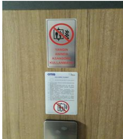
Resim 4.17. Yangın anında kullanılmaması gereken asansör
