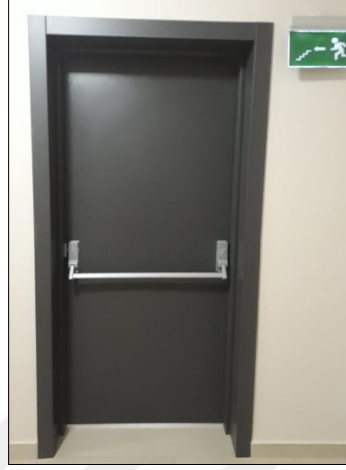
Resim 3.5. Kaçış yolu kapısı
