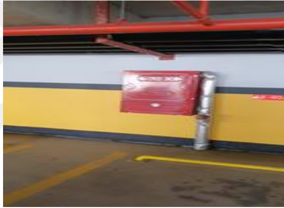
Resim 4.23. Donmaya karşı yalıtım yapılmış yangın dolabı borusu
