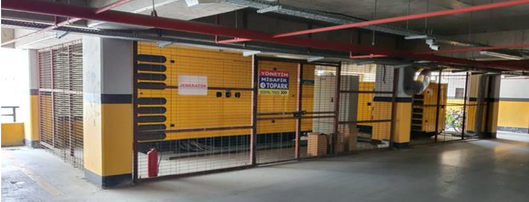
Resim 4.36. Açık garajda yaklaşma mesafe koruyucusu yapılmış ve yangın tüpü konuşlandırılmış jeneratör
