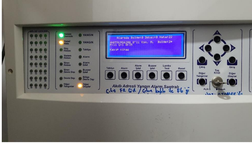
Resim 3.19. Adresli yangın alarm sistemi
