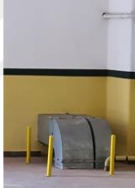
Resim 3.13. Havalandırma tesisatı ve sistemleri
